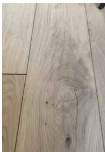
Spaccature centrali agli elementi.
