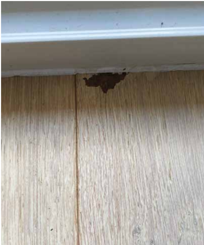
Elemento danneggiato zona giorno.
