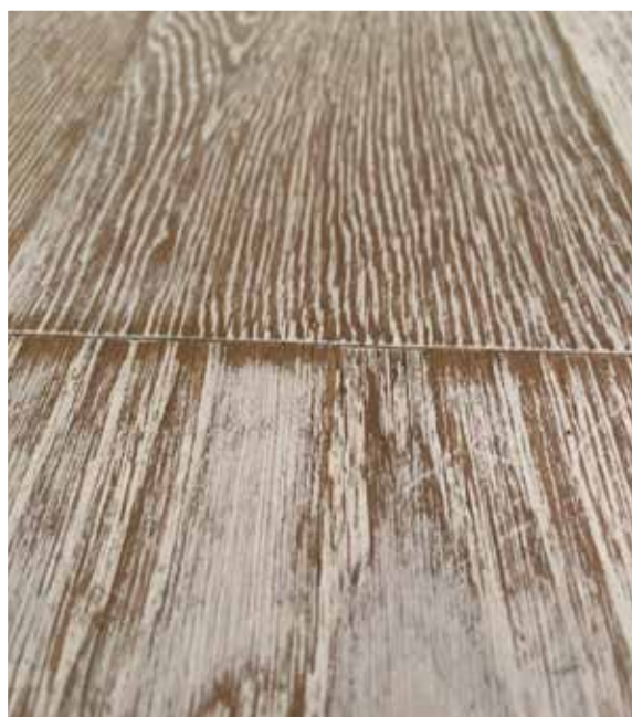
Particolare zona usurata.
